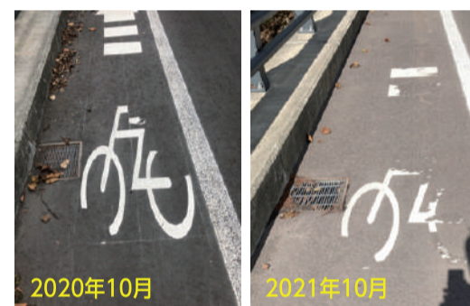
1年経過時の道路表示の劣化の様子
